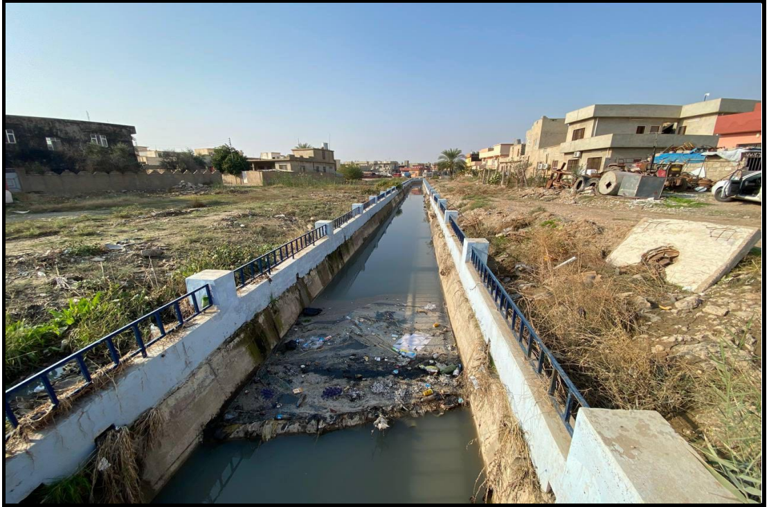
صورة (١) وادي ناقتورتايا لتصريف مياه الامطار
